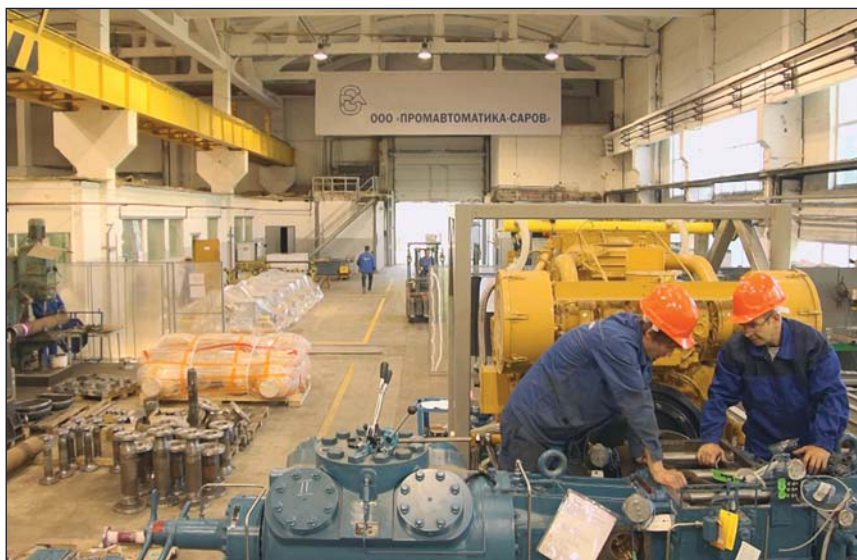
Рис. 2. Сборочный цех, пэкидж компрессорной установки 1 МВт привод CATERPILAR, компрессор ARIEL
